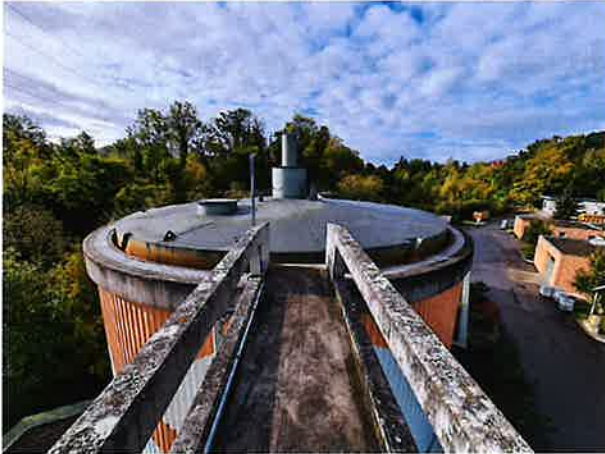
Gazomètre – Niveau haut
