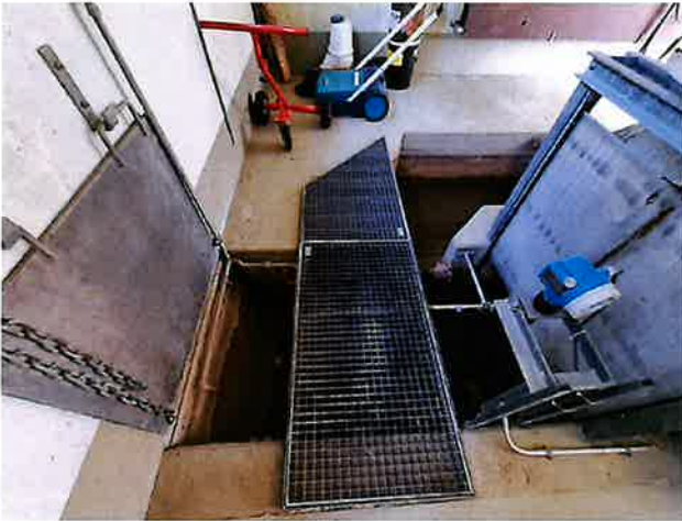
Dégrilleur grossier lamellaire
