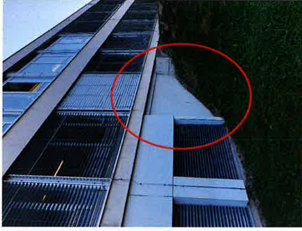
La façade extérieure pour prise d'air neuf et d'air rejeté
