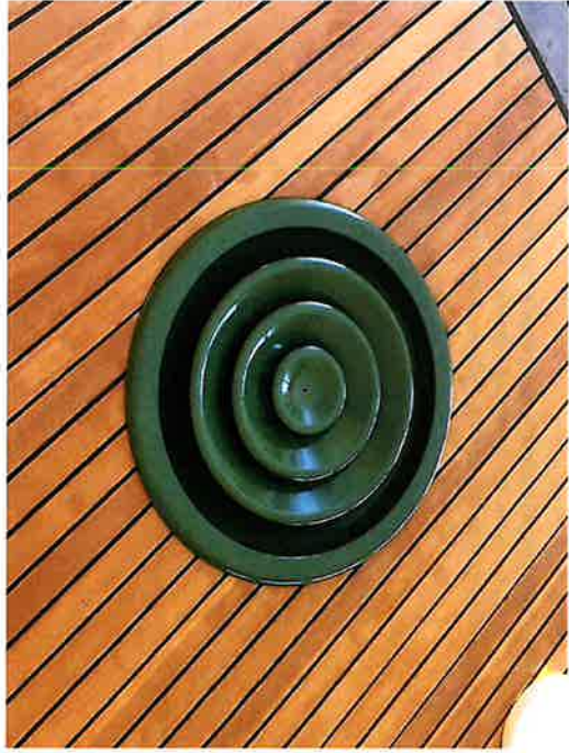
Les grilles de pulsion d'air à remplacer
